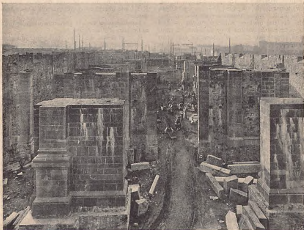
FLORENCE — Sanctuaire de la Sainte Famille - État des travaux vus de l'entrée.
